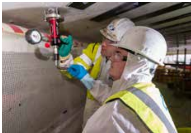
Ensaio de deslocamento para testar a força coesiva do substrato de concreto após a preparação da superfície
