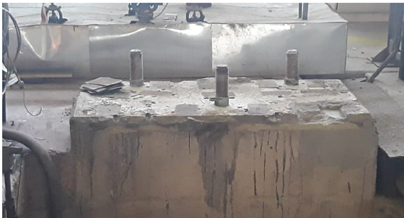
Base de concreto com fissuras, problemas de deslocamento e deformações.
