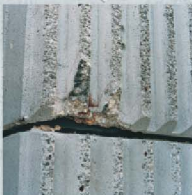
Fissuras devido ao instalação ou fixação incorreta de painéis pré-moldados.
