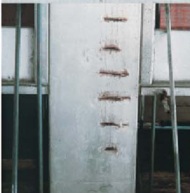
Corrosão da armadura devido à redução da proteção alcalina do concreto por carbonatação.
