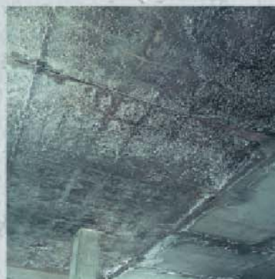
Efeito do ciclo de gelo e degelo na estrutura de um estacionamento.
