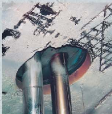
Ataque químico do concreto e conseqüente corrosão da armadura na cobertura de uma indústria.
