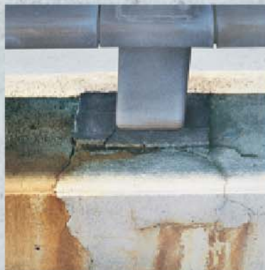
Danos à armadura evidenciados pelo produto de corrosão que escorre pelas fissuras devido ao contato com o perfil em aço galvanizado fixado na estrutura.
