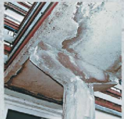
Efeitos danosos da corrosão do aço acelerada pela presença de cloretos.
